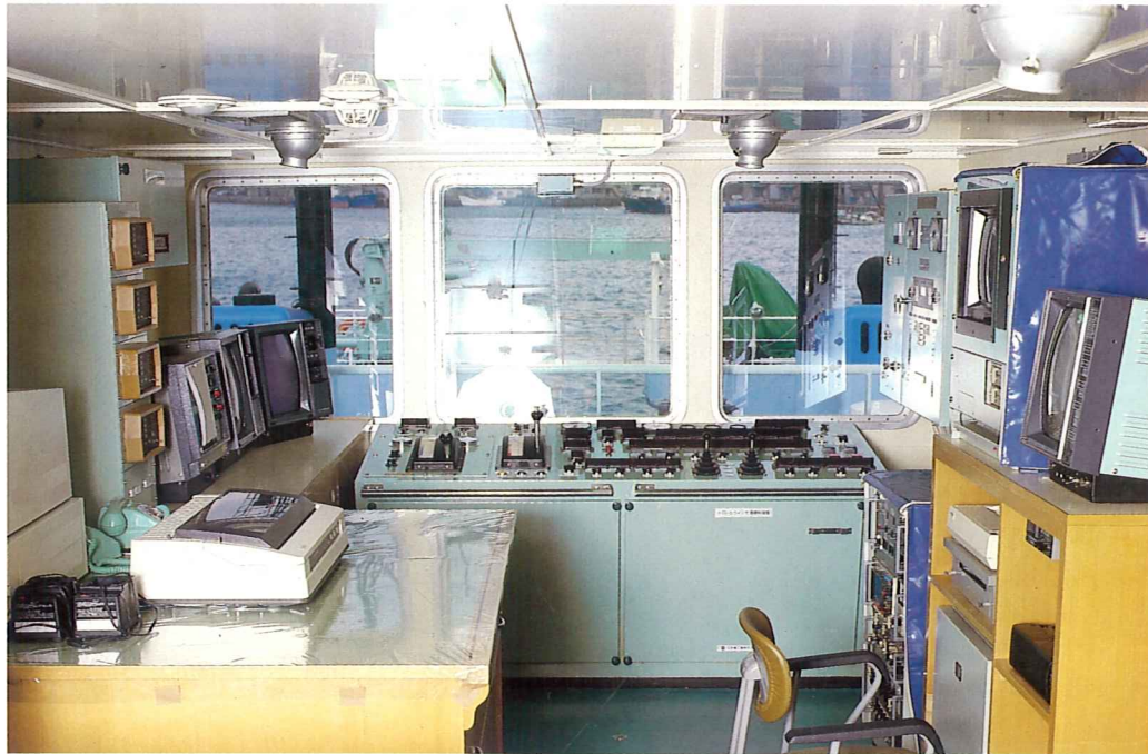
トロール制御所 TRAWL CONTROL ROOM
