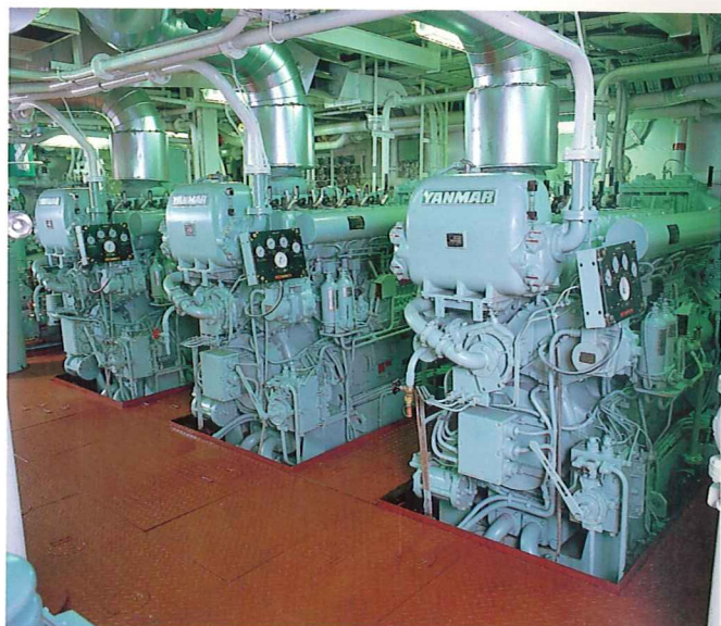
発電機 GENERATOR ENGINE
