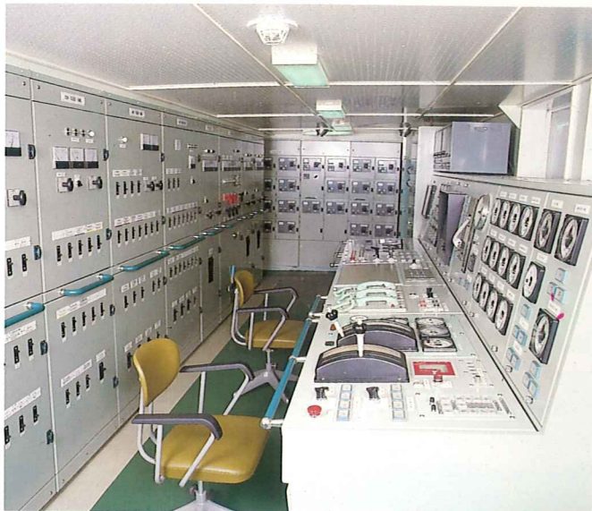
機関制御室 ENGINE CONTROL ROOM
