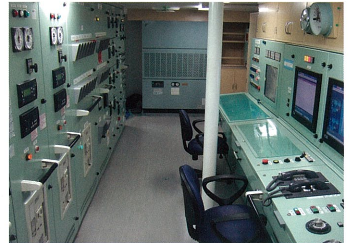
機関制御室 ENGINE CONTROL ROOM
