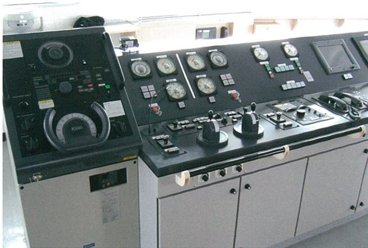
操舵室 推進制御盤 (WCC) WCC IN BRIDGE
