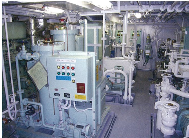
機関室 ENGINE ROOM
