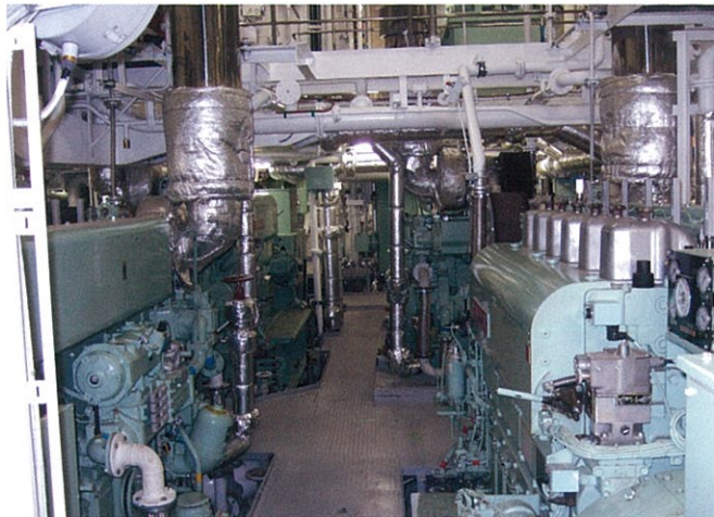
機関室 ENGINE ROOM
